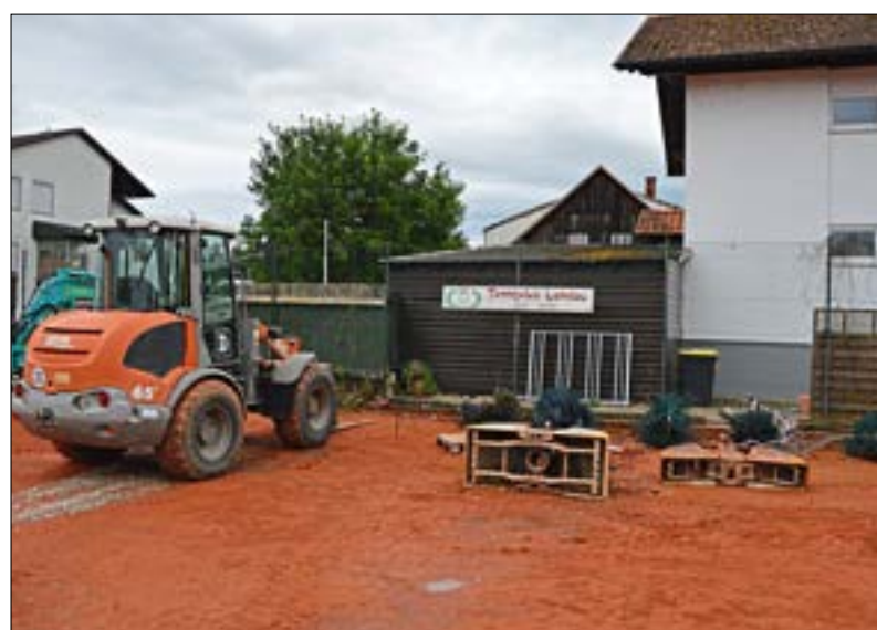
Das Jubiläumsschild hängt noch. 1957 wurde der Verein gegründet und die Plätze gebaut. Eine Sanierung war unausweichlich.
