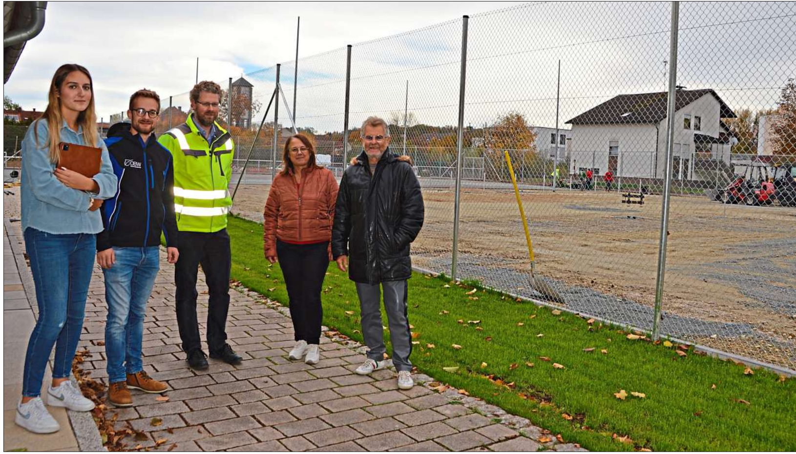
Sie sind zufrieden mit dem Baufortschritt: Mirta Parasilovoc (von links) und Projektleiter Thomas Ebner von OBW, Stadtbauamtsleiter Michael Schmidt-Ramsin, Stadtkämmerin Gerlinde Radspieler und TC-Vorstandsmitglied Rupert Rebl. – Fotos: Nadler
